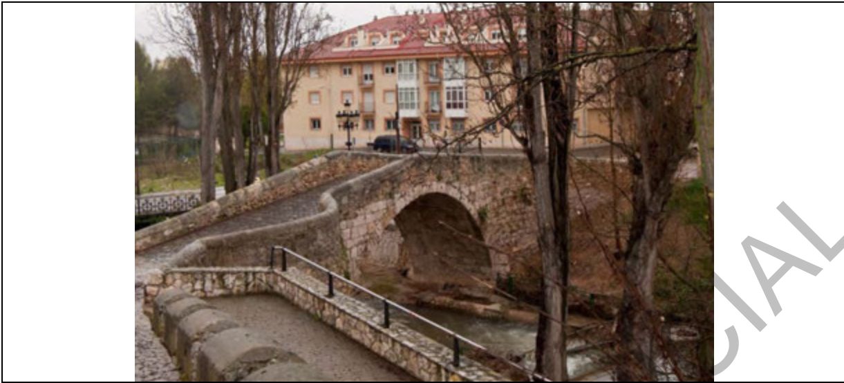
Vista general del puente de San Juan, fotografía realizada desde el este en dirección oeste.
