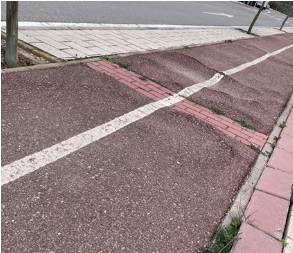
Figura 14. Carril bici de la ruta 8 en mal estado
